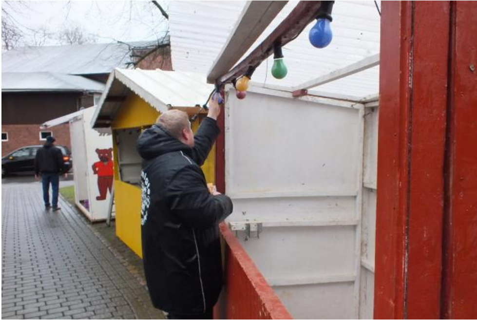
Unter Strom: Lichtinstallation für die dunkle Zeit
