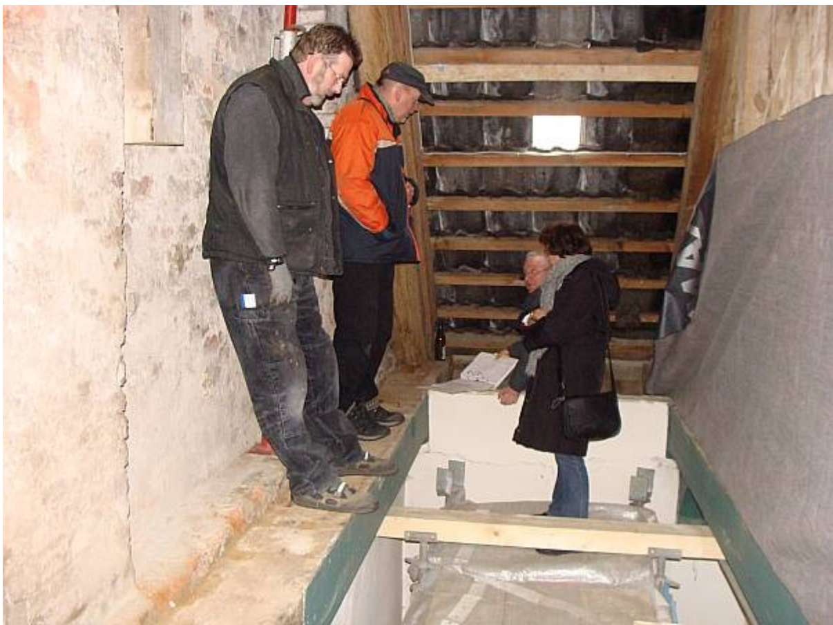
Ralf Schweitzer (Bauausschussvorsitzender der Kirchengemeinde Edde lak), Hans-Georg Veers (Bauverwaltung des Kirchenkreises), Siegfried Preis (Ingenieurbüro Nagel aus Marne) und Ingrid Wenk (Nordelbisches Kirchenamt Kiel) bei der entscheidenden Begehung im Kirchturm und in der St.Marienkirche. Der Balken muss erneuert werden.
